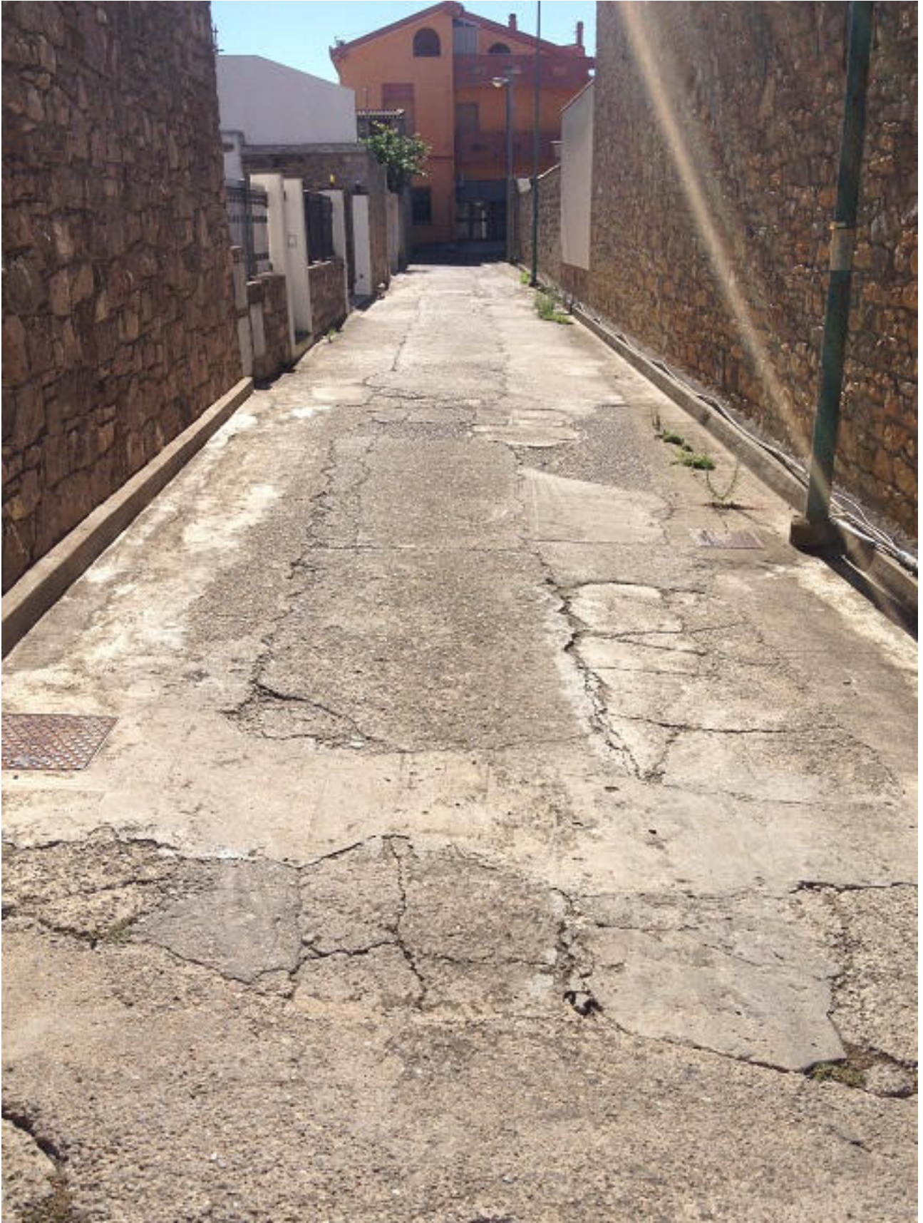
Foto n.8 – Sardara: Vico III° F. Nuova (degrado viabilità)
