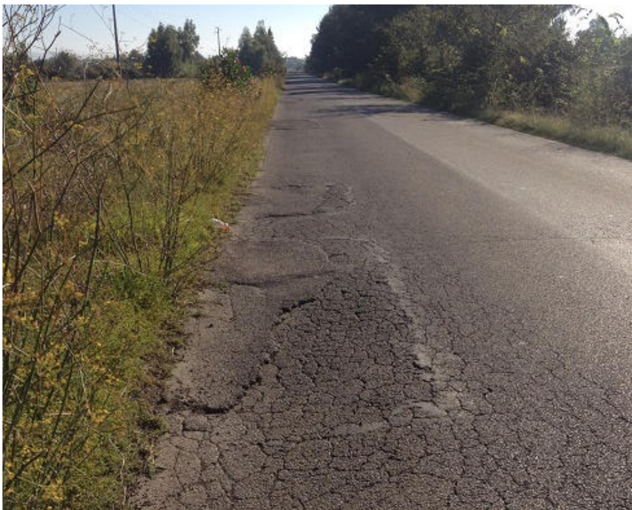
Foto n.21 – San Gavino Monreale: prolungamento via Po (degrado viabilità)
