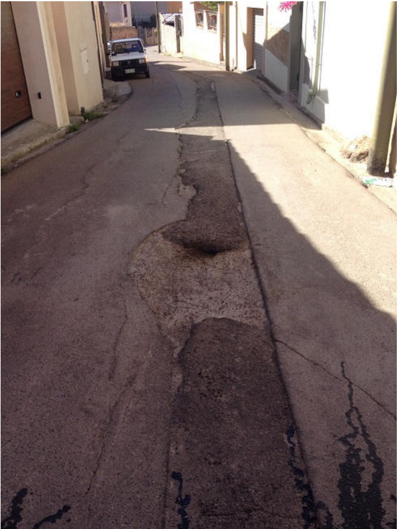
Foto n.10 – Sardara: Via Grazia Deledda (degrado viabilità)
