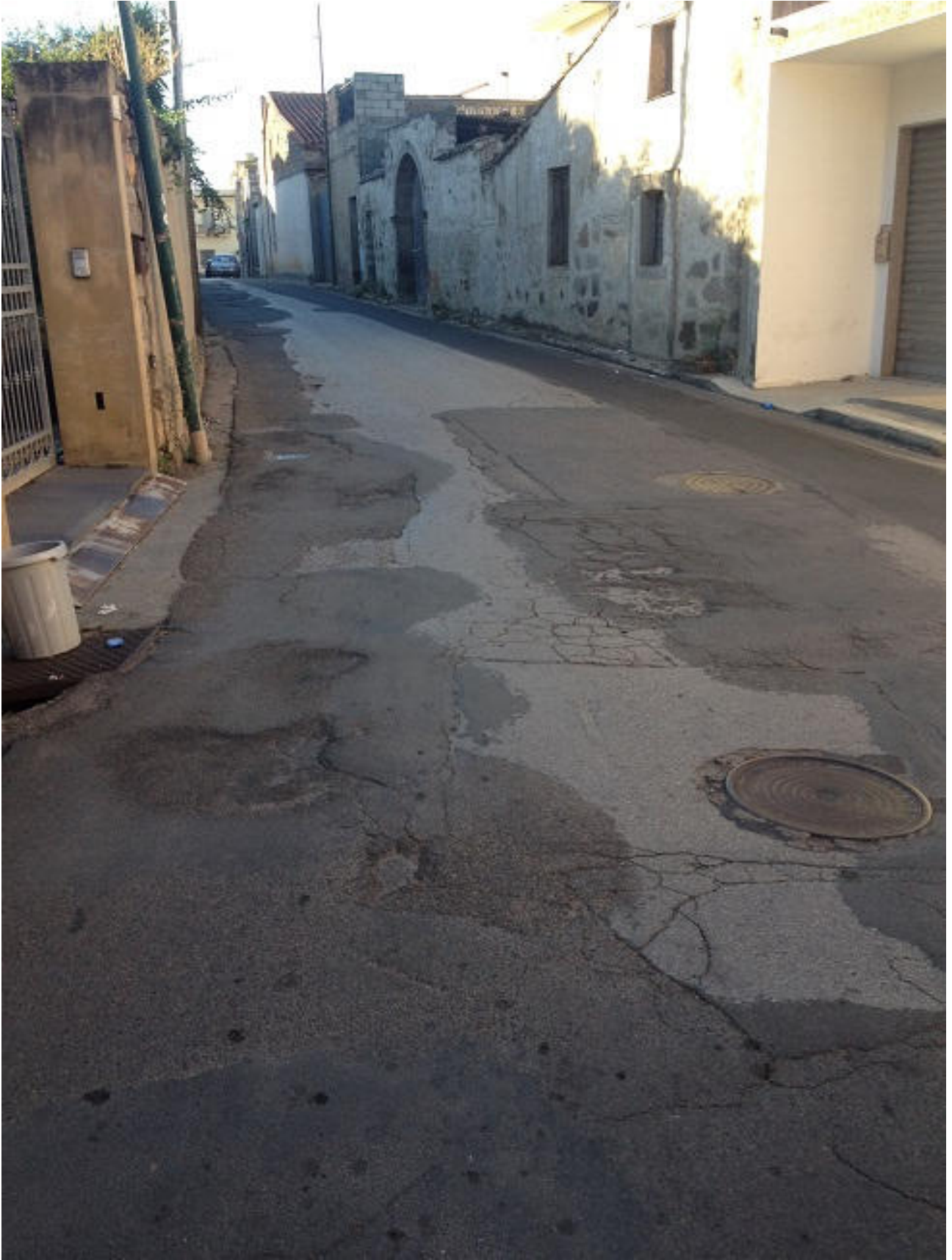
Foto n.15 – Serrenti: Via Roma (degrado viabilità)
