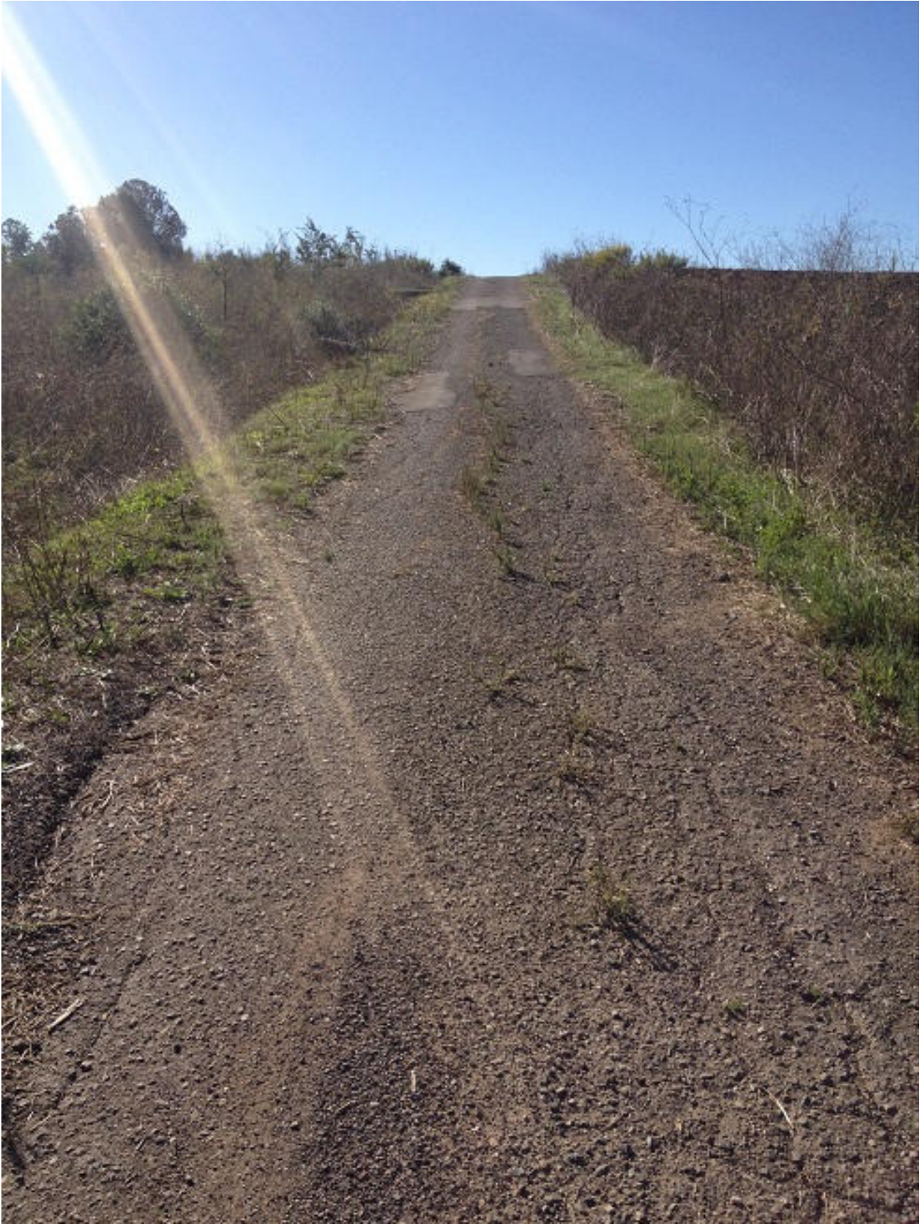
Foto n.12 – Sardara: Strada “ex CBSM” (degrado viabilità)
