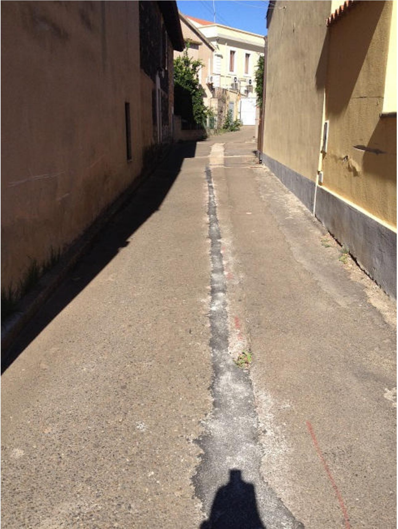
Foto n.7 – Sardara: Vico II° F. Nuova (degrado viabilità)
