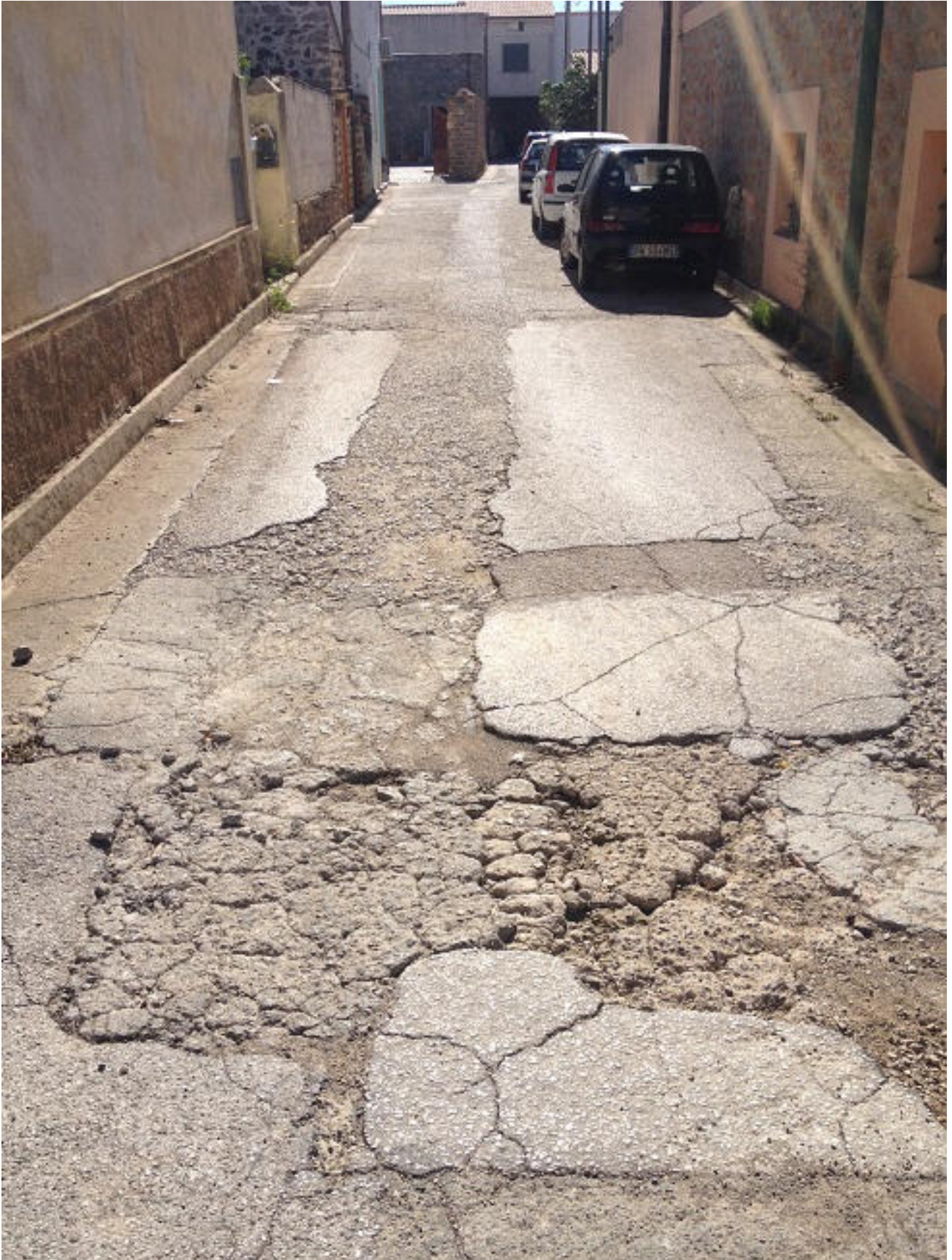
Foto n.6 – Sardara: Vico I° F. Nuova (degrado viabilità)
