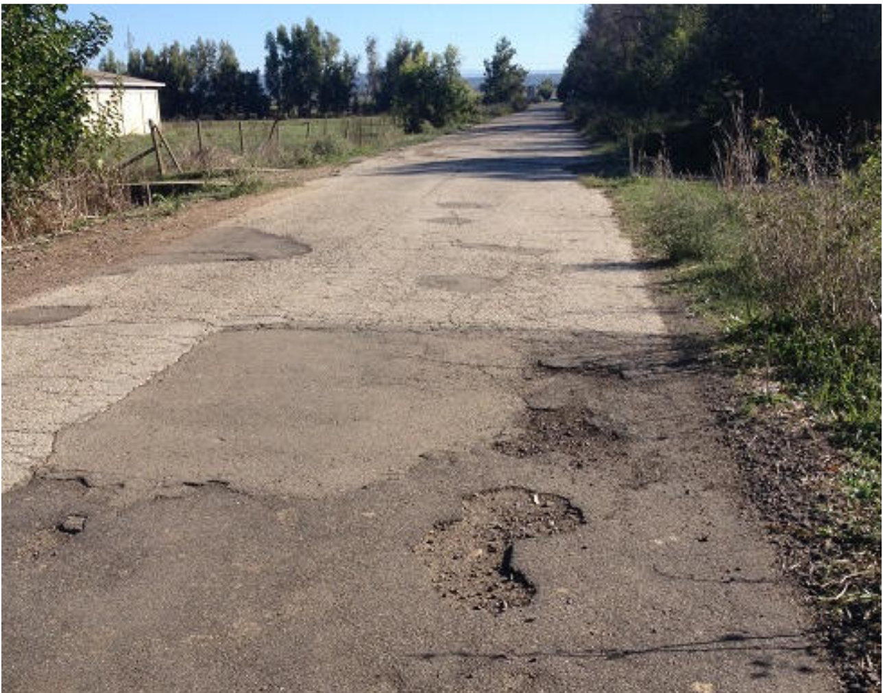
Foto n.3 – Pabillonis: strada extraurbana Zeppara-via dei Gabbiani (degrado viabilità)
