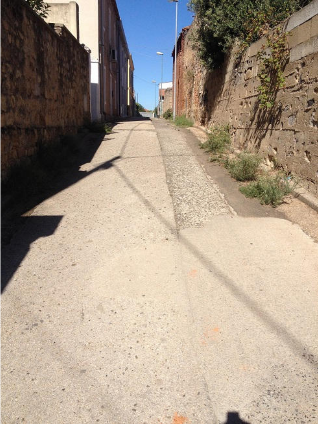
Foto n.9 – Sardara: Vico IV° F. Nuova (degrado viabilità)
