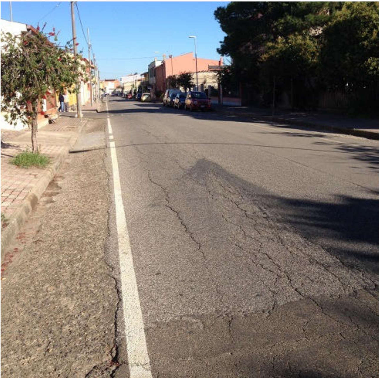
Foto n.2 – Pabillonis: via Cagliari (condizioni manto stradale)
