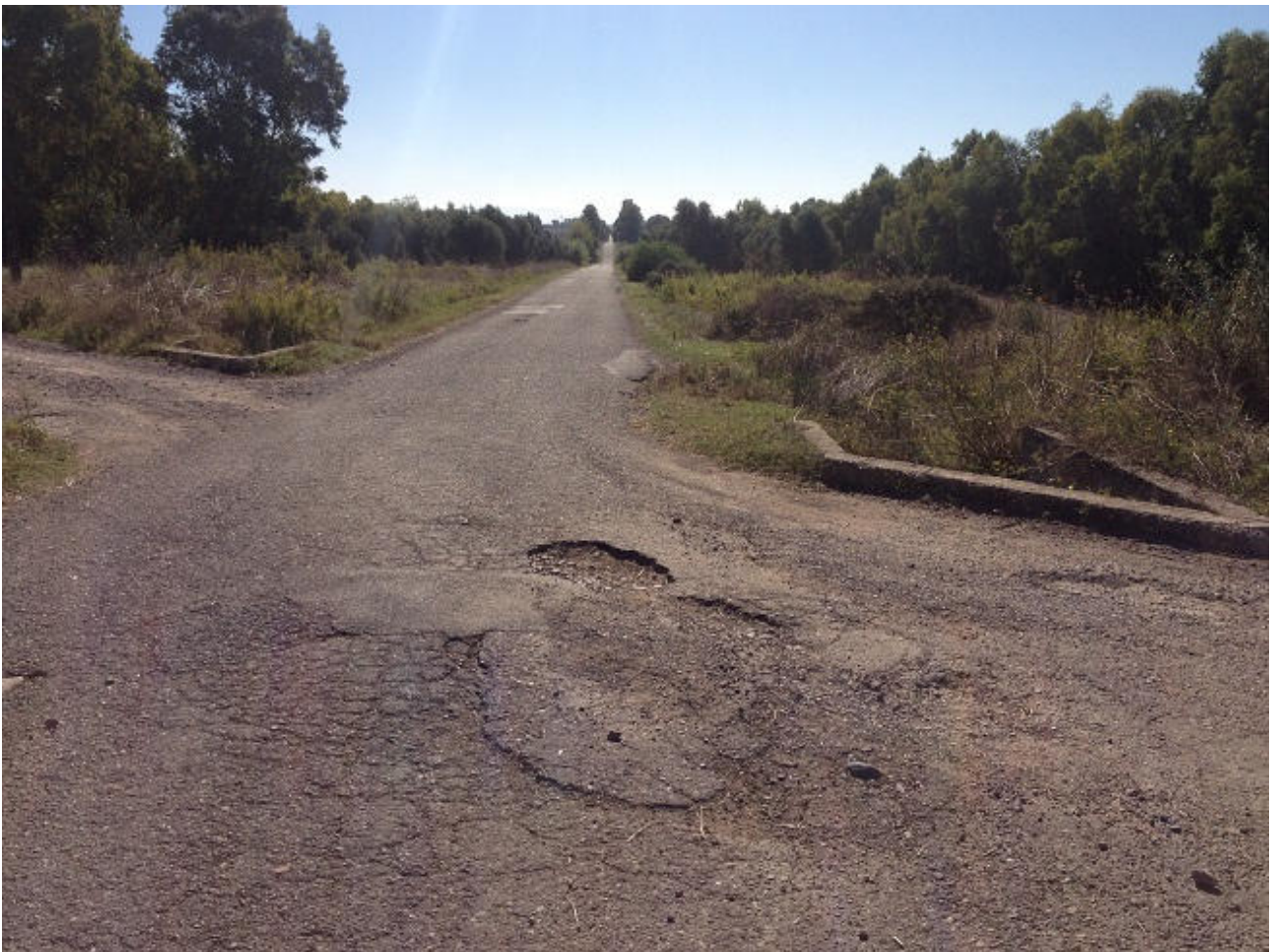
Foto n.11 – Sardara: Strada “ex CBSM” (degrado viabilità)
