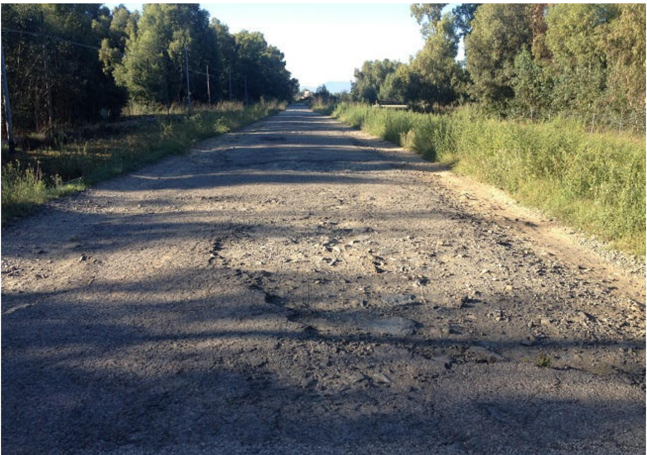
Foto n.19 – Serramanna: Strada Comunale Samassi-Vallermosa (degrado viabilità)
