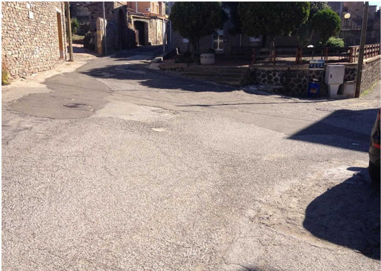
Foto n.5 – Sardara: Piazza Napoli (degrado viabilità)
